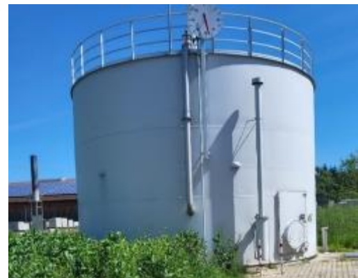
Gasspeicher mit Fackel
